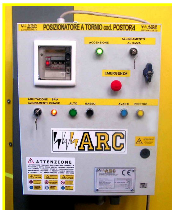
QUADRO COMANDI SU' POSTAZIONE FISSA
