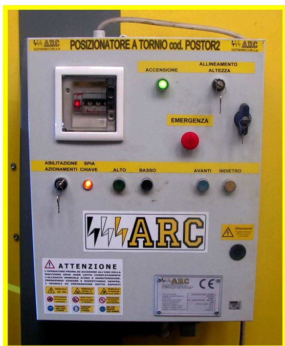
QUADRO COMANDI SU' POSTAZIONE FISSA
